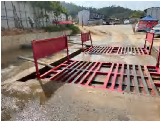
照片 3 洗车池和沉砂池
