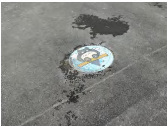
照片 3 雨水管网 3
