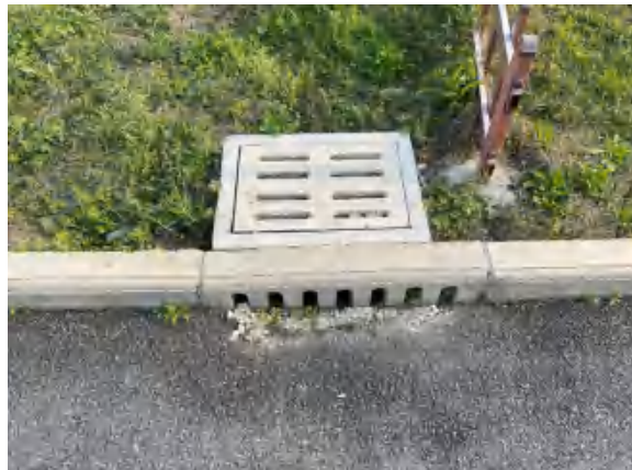
照片 2 雨水管网 2
