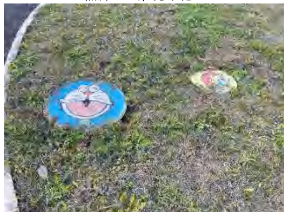
照片 12 雨水管网
