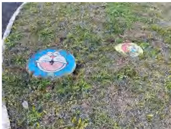
照片 15 雨水管网
